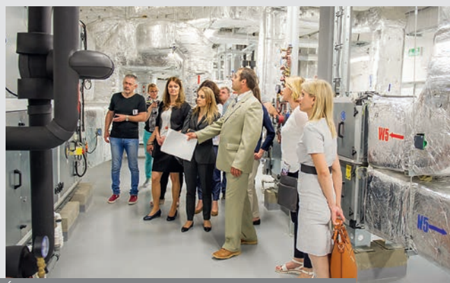
ŚCO – zaplecze infrastrukturalne – systemy wentylacji i sterylizacji
